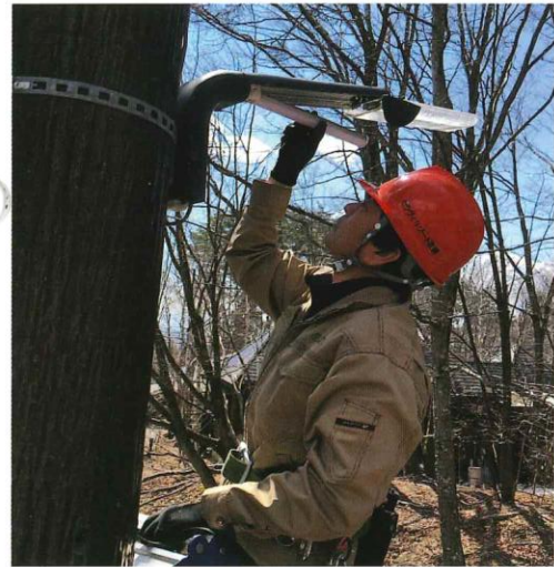
快適かつ安全な分譲地を維持するため、不具合が見つかった街路灯の速やかな復旧に努めています。
