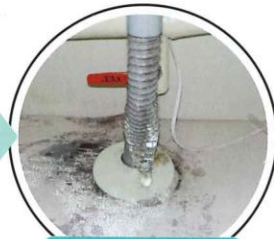
水道管の破裂
