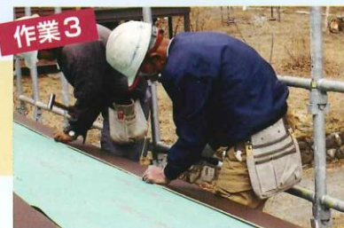
防水のためのルーフィングシートを敷き、その上に屋根材を貼っていきます。
