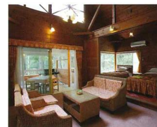
家具の老朽化や床、壁面の汚れなど、経年による劣化が見られました。
