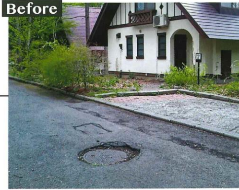
マンホールの陥没が特にひどい2カ所の修繕工事を実施しました。
